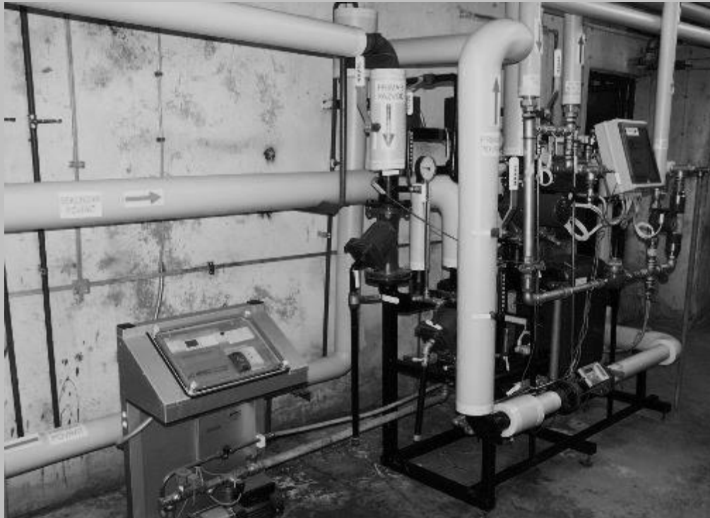
Prefabrikovana PS Zagorska br. 12
